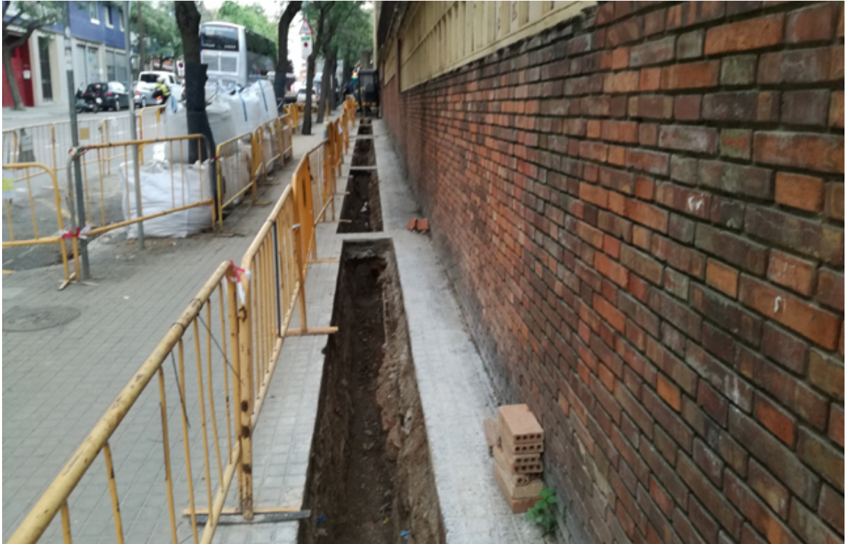
FOTOGRAFIA 7 → Imatge del tram sud de la rasa, un cop excavada, on observem els diverses canalitzacions prèvies, a banda i banda, des del sud.
