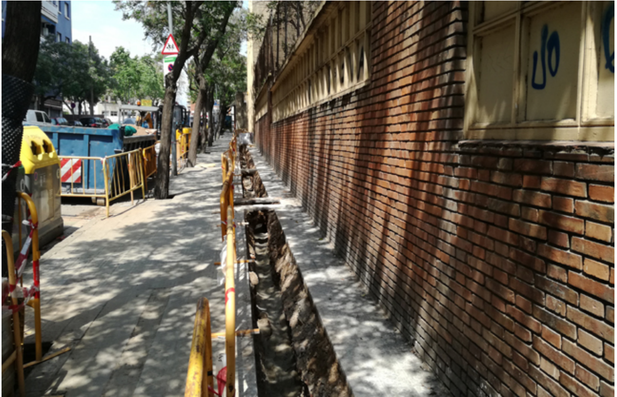
FOTOGRAFIA 9 → Vista final de la rasa per canalitzar la nova línia elèctrica, un cop acabada d'excavar, des del sud, a la cantonada amb el carrer Camp del Ferro.
