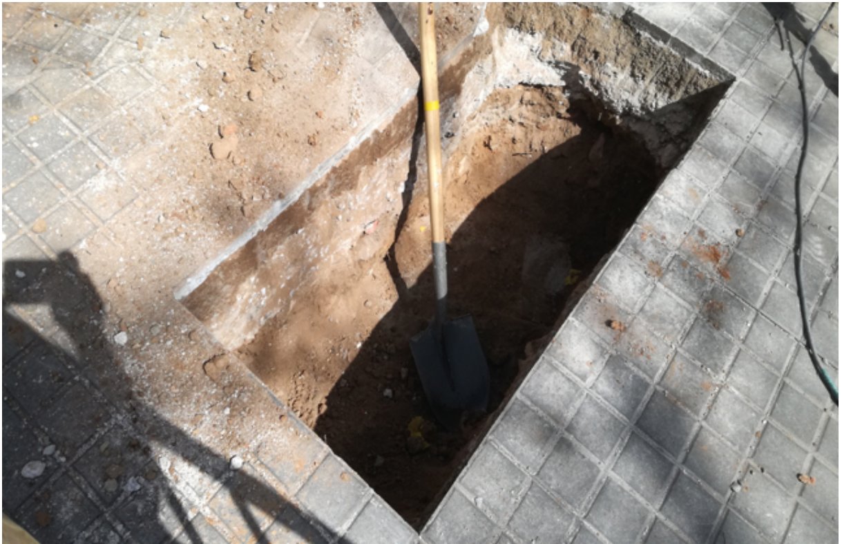
FOTOGRAFIA 3 → Vista de detall de la primera cala de sondeig, a la cantonada amb el carrer Camp del Ferro, des de l'oest.
