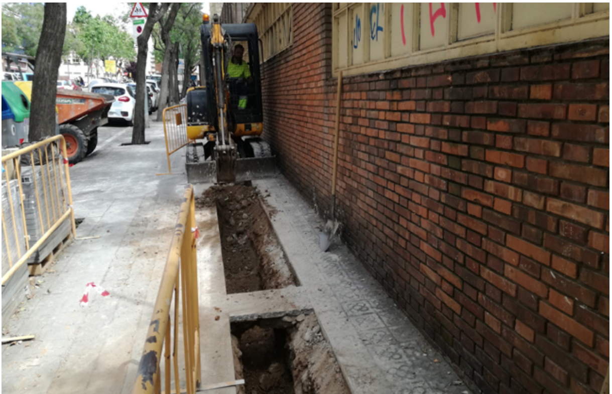
FOTOGRAFIA 6 → Vista de la màquina excavadora durant les tasques d'obertura de la rasa, des del sud.
